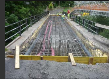
EDAR I COL·LECTORS AUBÈRT
